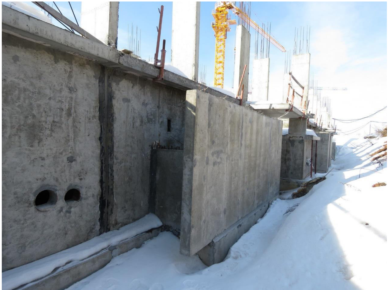
Рис. 3.1.13 Отсутствие 2-х слоев вертикальной оклеечной гидроизоляции гидростеклоизола типа «ЭПП» и дренажной мембраны типа «Дрениз» на монолитной железобетонной фундаментной плите, наблюдается по всему периметру здания
