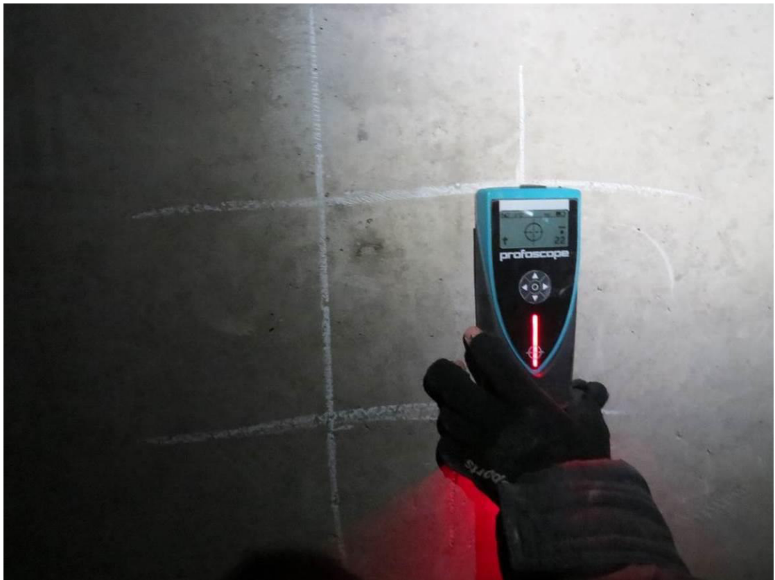
Рис. 3.3.4. Определение положения рабочей арматуры и толщины защитного слоя бетона в монолитной ж.б. плите перекрытия магнитным методом прибором «Profoscope»
