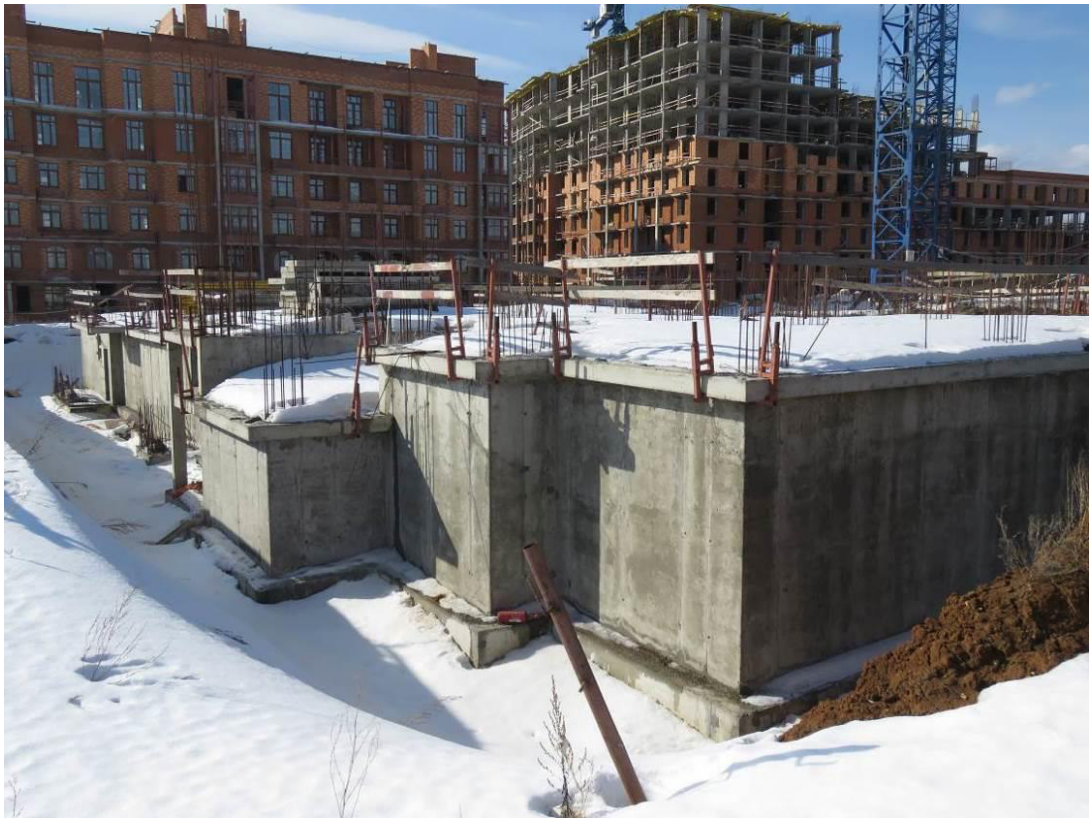
Рис. 1.3. Общий вид возведенных строительных конструкций по оси А/2 между осями 1/2-27/2 секций №№4-5 жилого дома №18
