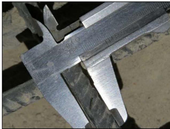
ФОТО 14. Уточнение диаметра рабочей арматуры монолитной железобетонной фундаментной плиты расположенной между осями «22/1»-«23/1» и «ИИ/1»-«КК/1».
