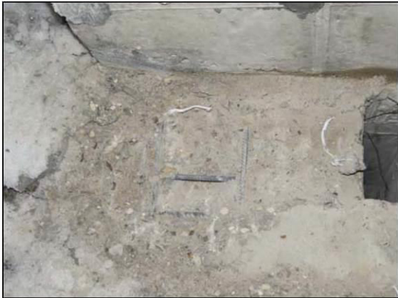
ФОТО 17. Общий вид вскрытия напольной поверхности железобетонной плиты перекрытия подвала на пересечении осей «Я/1» и «6/1».
