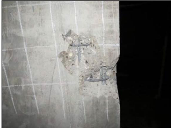
ФОТО 9. Общий вид вскрытия монолитного железобетонного пилона расположенного на пересечении осей «20/1» и «ЖЖ/1».
