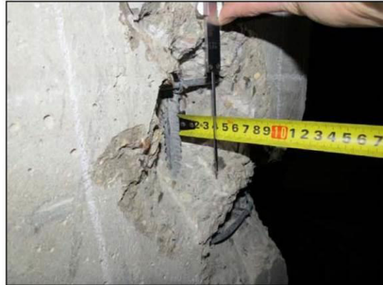
ФОТО 10. Уточнение защитного слоя бетона железобетонного пилона расположенного на пересечении осей «20/1» и «ЖЖ/1».
