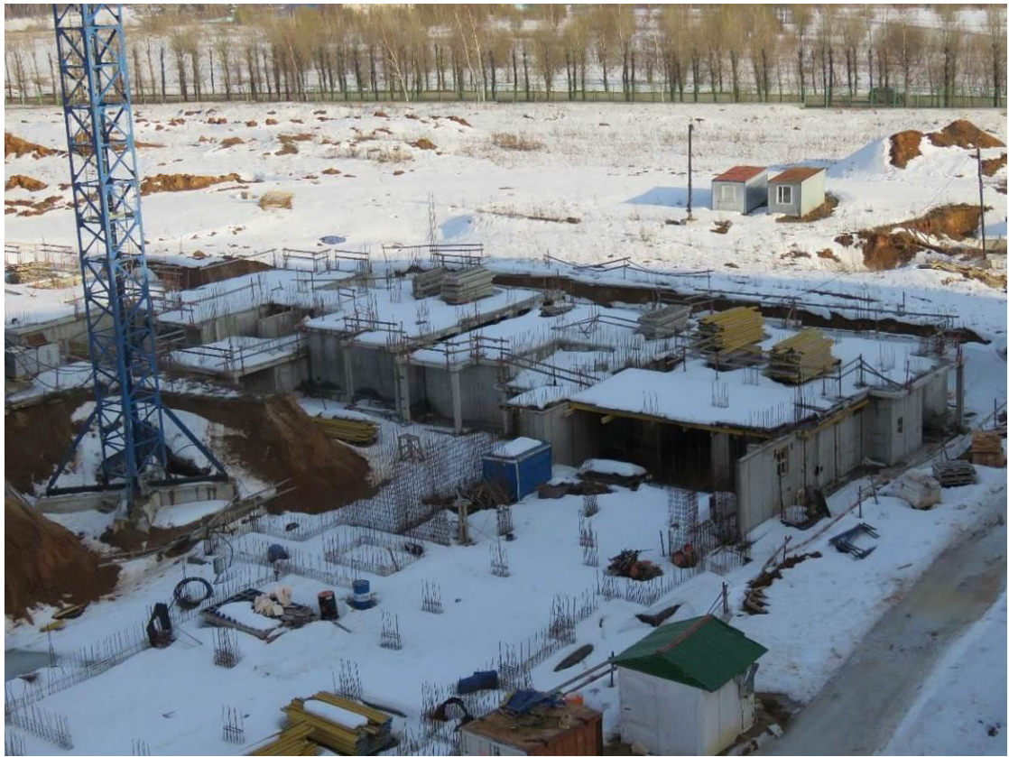
Рис. 3.3.1. Общий вид смонтированных монолитных ж.б. плит перекрытий первого этажа секций 4 и 5 здания
