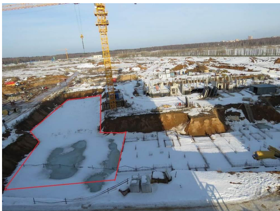
Рис. 3.1.2. Общий вид отсутствия смонтированных фундаментных конструкции секций №№9-11
