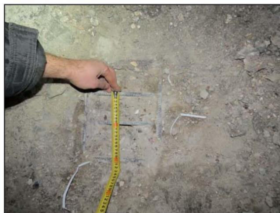
ФОТО 16. Уточнение шага рабочей арматуры напольной поверхности железобетонной плиты перекрытия подвала на пересечении осей «Ю/1» и «20/1».
