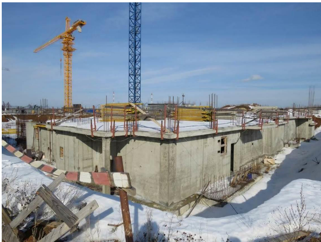
Рис. 3.1.12 (а, б) Отсутствие мероприятий по предохранению грунтов основания фундаментной плиты от промерзания, в виде консервации и обратной засыпки пазух котлована, наблюдается по всему периметру здания
