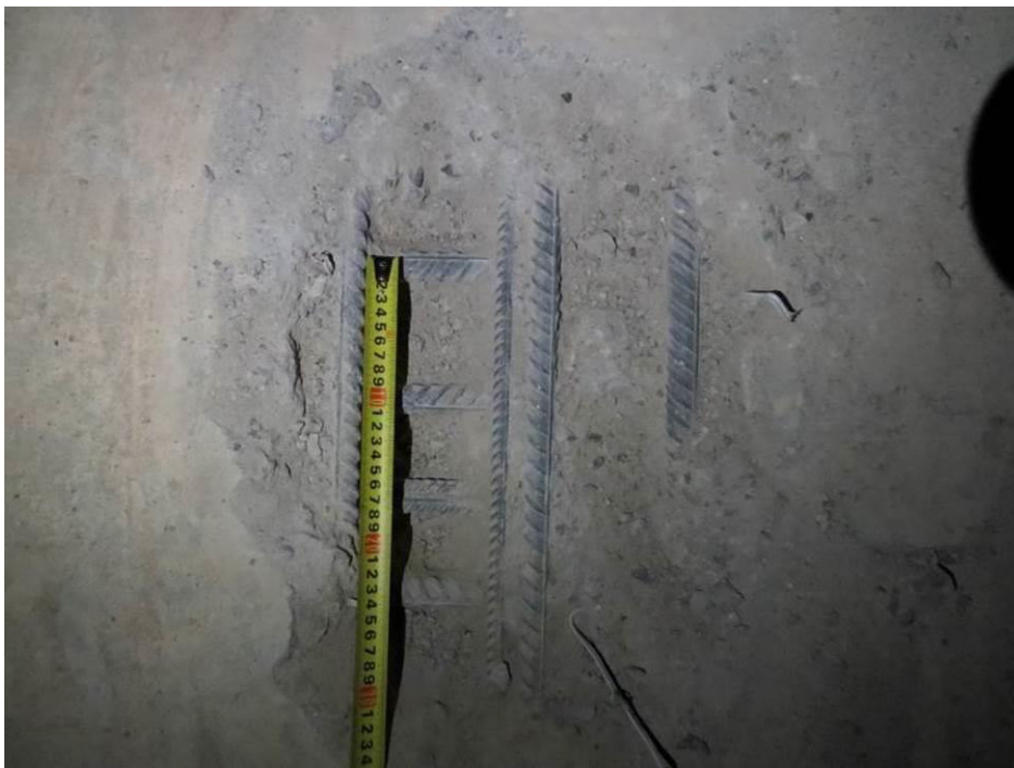
Рис. 3.1.6. Замер шага (230 мм) вдоль буквенных осей верхней зоны армирования фундаментной плиты секции 1 между осями ЖЖ/1-КК/1, 21/1-24/1
