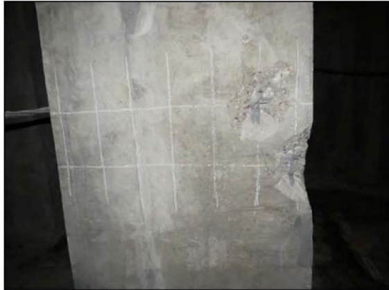
ФОТО 5. Общий вид вскрытия монолитного ж/б пилона подвала по оси «КК/1» между осями «18/1» и «20/1».
